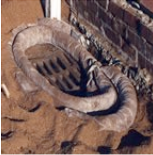
Barrera en una alcantarilla
